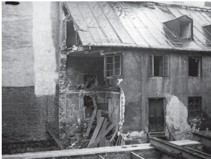
Katastrofa budowlana. Rok 1938
