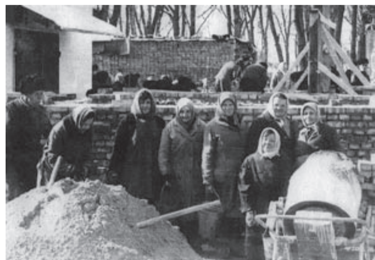
W Gródku były dwa kościoły: św. Anny i św. Stanisława zburzone w 1936 roku przez Sowieców. Pozostała tylko kapliczka cmentarna, wokół której mieszkańcy Gródka zbudowali kościół św. Stanisława. Na fotografii prace budowlane przy kościele w latach siedemdziesiątych
